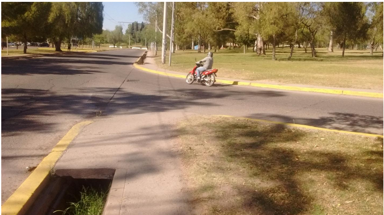
Imagen 22: Falta de rampas en el ingreso Oeste al Campus
