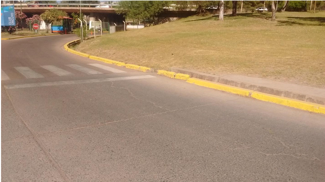
Imagen 20: Rampas inexistentes en un paso peatonal cercano al ingreso a la Secretaría de Deportes
