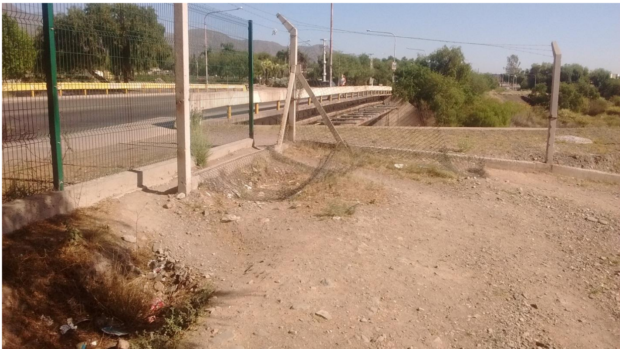
Imagen 11: Ingreso peatonal informal en el extremo Noroeste del Campus
