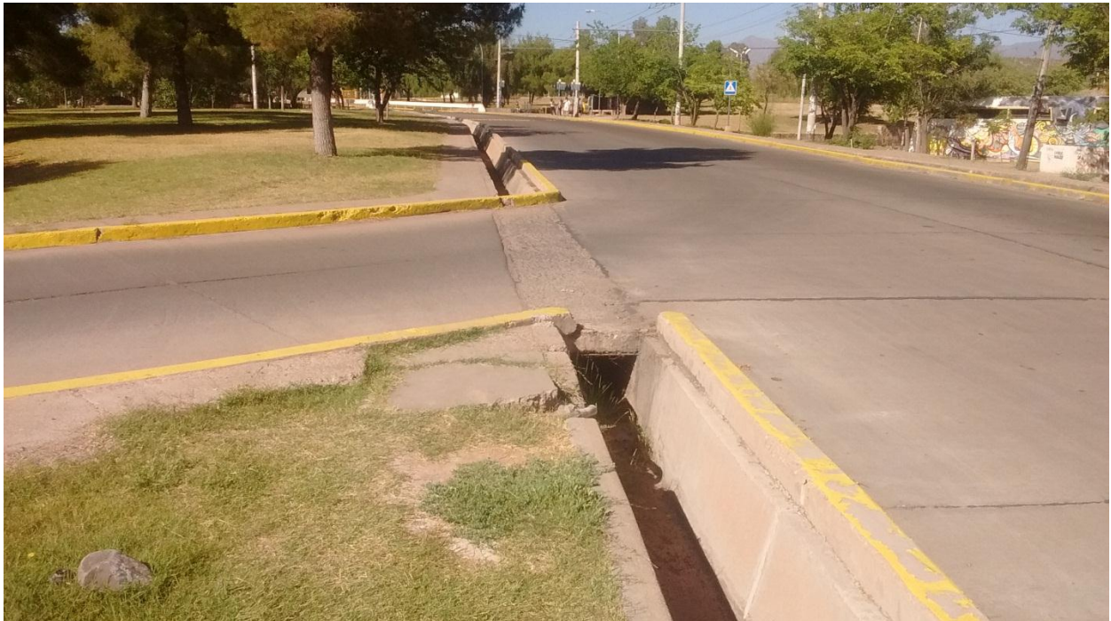
Imagen 21: Falta de continuidad de las veredas y rampas inexistentes ubicada en la salida del estacionamiento de la Facultad de Filosofía y Letras
